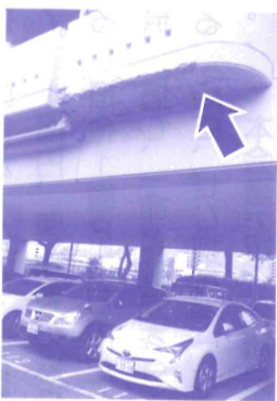
ベランダ基部の損傷が激しい、県営長寿園南1号館
